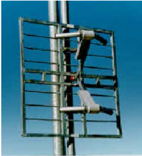
Figura 8.14 ANTENA TRANSMISIÓN VHF BANDA III
