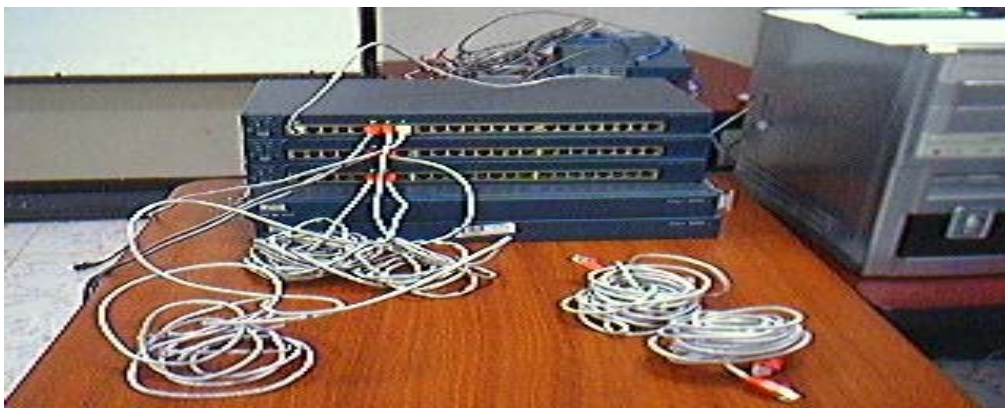
Figura 4 switches y routers utilizados en las pruebas, todos de marca CISCO.
