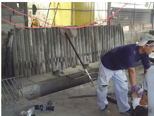
FIGURA 4.3 CANAL DE ENFRIAMIENTO ABIERTO
