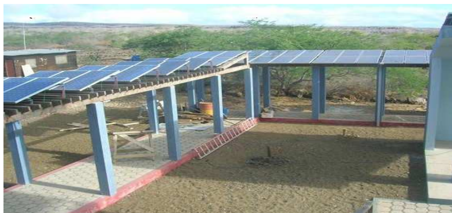
FIGURA 2.31. SISTEMA FOTOVOLTAICO EN ISLA FLOREANA, PROVINCIA DE GALÁPAGOS
