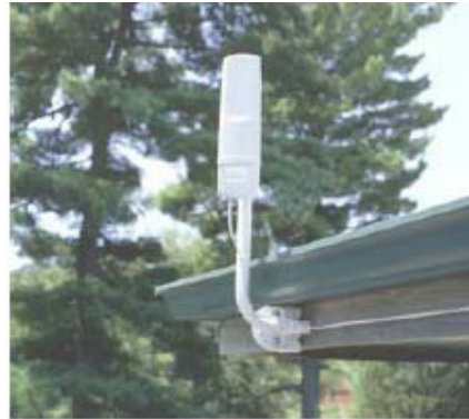
Figura 5.3: CPE montado en estructura
