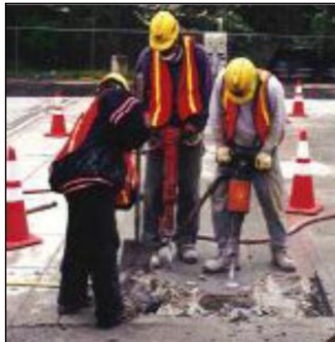
Figura 4-4: Parche superficial de la capa de rodadura
