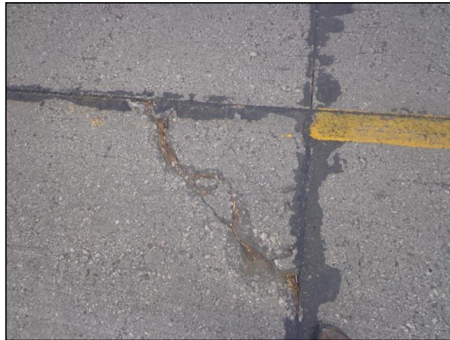
Figura 5-8: Grieta de esquina
