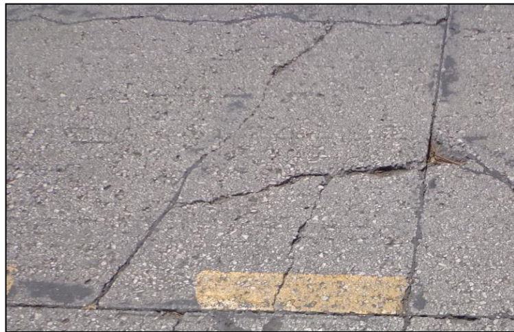
Figura 5-9: Grieta diagonal originada a partir de una longitudinal (Fuente: Basantes C., Zambrano T., 2013)
