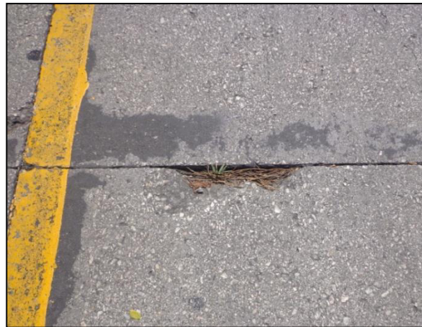
Figura 5-12: Despostillamiento en junta (Fuente: Basantes C., Zambrano T., 2013)
