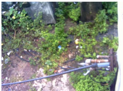
Foto 13 Conexión clandestina de 2", ubicadas en los predios donde se encuentra el Tanque Elevado y la Cisterna Alta.
