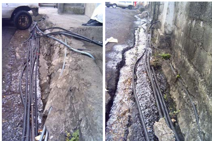
Foto 20 En el callejón 12 de octubre se encontraron más de 15 mangueras flex de ½” conectadas ilegalmente a varias de las guías múltiples de ½”.
