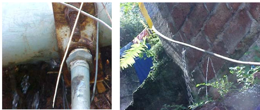
Foto 9 En el 9no callejón, fugas visibles debido a roturas de mangueras
