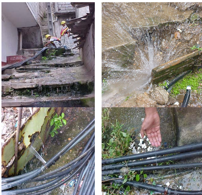
Foto 10 En el 9no callejón se presentan fugas visibles debido a las malas uniones
