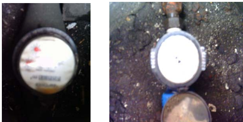
Foto 18 Medidores pertenecientes al Canal 5 "TELEAMAZONASTV".
