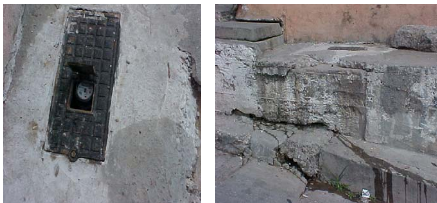
Foto 11 Fuga interna en un medidor por mala conexión de guía.
