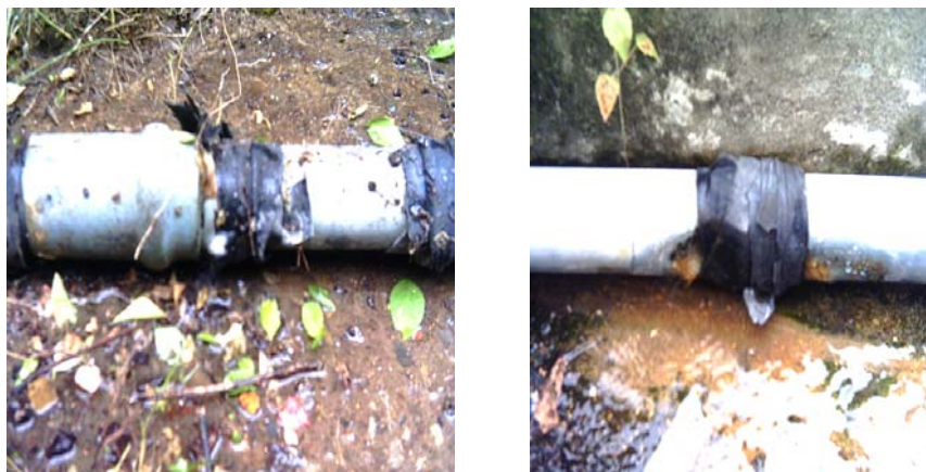
Foto 3 Fugas existentes causados por las malas uniones
