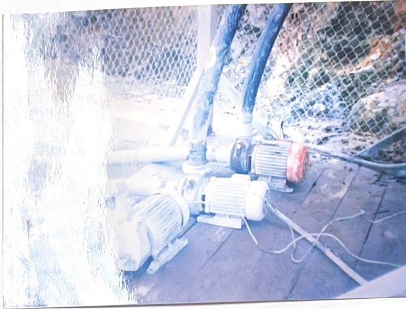
Foto 13.- Bombas de agua
