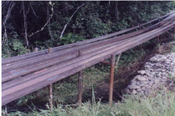
Figura 2.7: Tuberías de superficie
