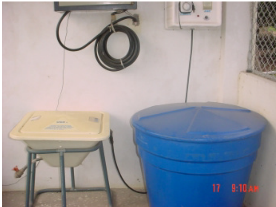
Foto 12. Sistema de cloración usado en las Juntas de agua Potable.
