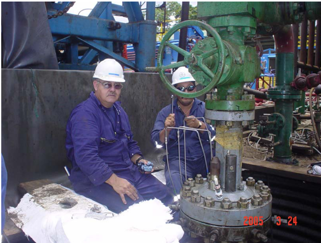
Figura 4.6 Conexión de Líneas en Cabezal del Pozo.
