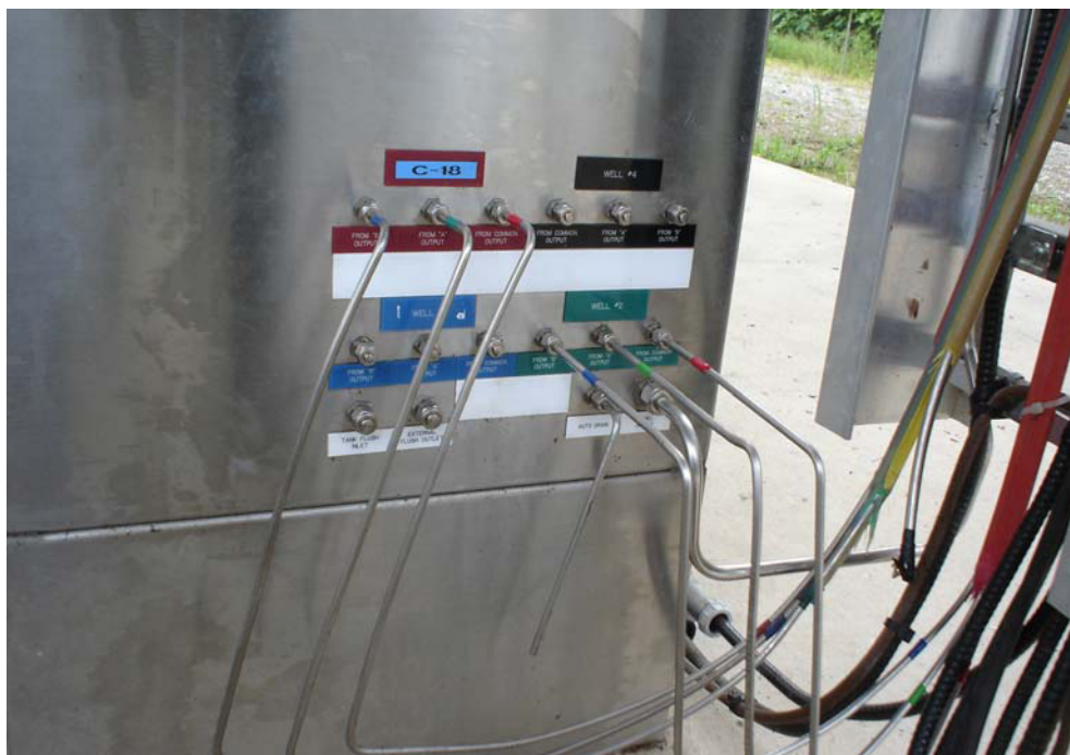
Figura 4.7 Conexiones de Líneas a Panel de Control.
