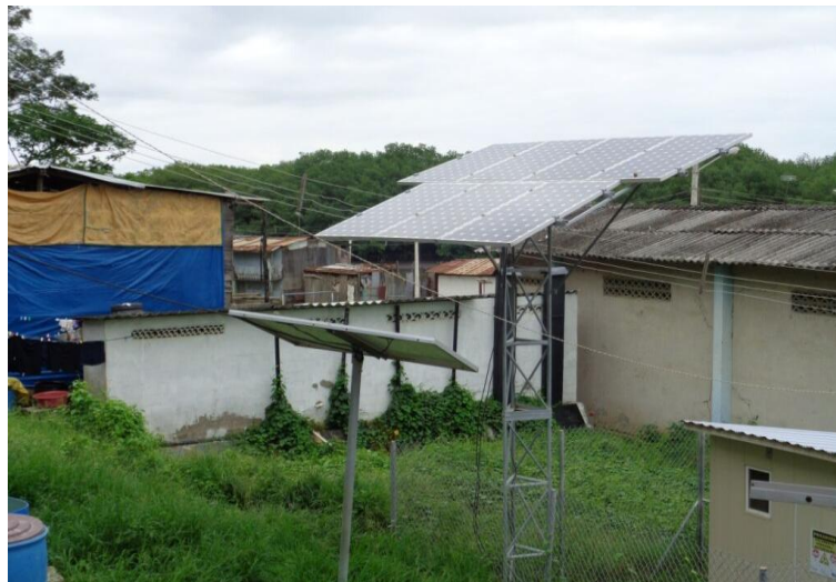
FIGURA 3.3 PANELES FOTOVOLTAICOS ORIENTADOS HACIA CUALQUIER DIRECCIÓN.
