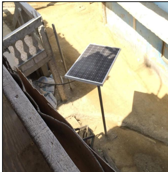
FIGURA 2.7 PANEL FOTOVOLTAICO OBSTRUIDO
