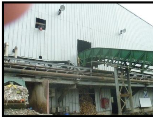
Figura1. 2 Entrada al disgregador
