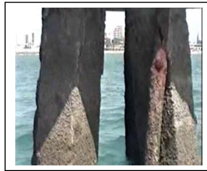
Tubo deteriorado bajo duque de alba zona variación de marea
