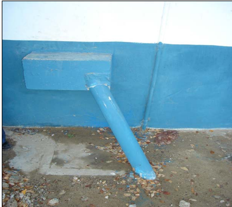
Figura. 3.15 TUBERIA DE 4 PULGADAS DE PVC DE SALIDA DEL CUARTO DE BOMBAS
