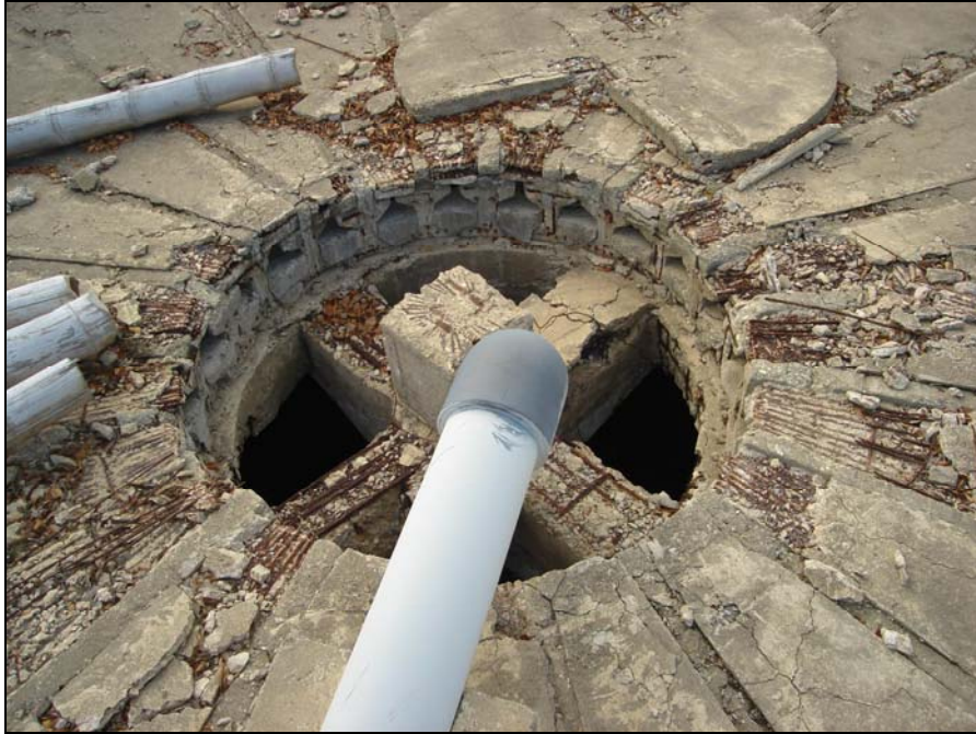
Figura. 3.12 ESTADO DE LAS TAPAS DE INGRESO DE AGUA A LOS TANQUES CIRCULARES DE CONCRETO (VISTA SUPERIOR)
