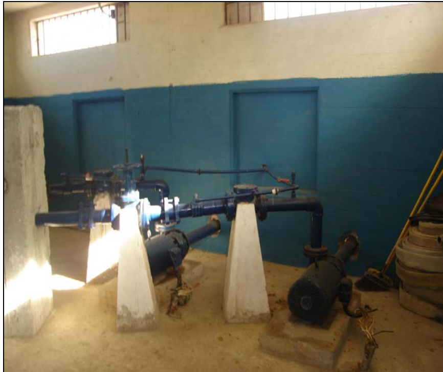
Figura. 3.18 VISTA INTERIOR DEL CUARTO DE BOMBAS
