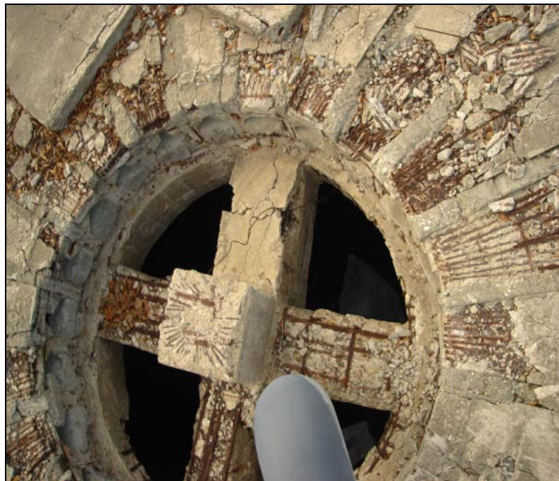
Figura. 3.12 ESTADO DE LAS TAPAS DE INGRESO DE AGUA A LOSTANQUES CIRCULARES DE CONCRETO (VISTA SUPERIOR)
