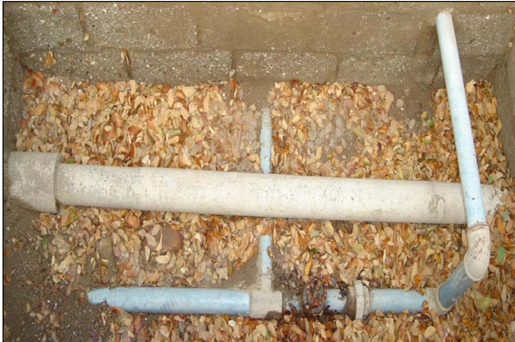
Figura. 3.16 TUBERIA DE 1 PULGADA PARA EL ENVIO DE AGUA A LAS VILLAS DE OFICIALES
