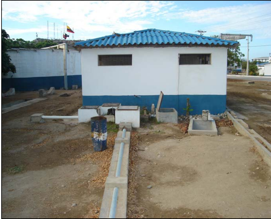
Figura. 3.19 TUBERIA DE INGRESO AL CUARTO DE BOMBAS
