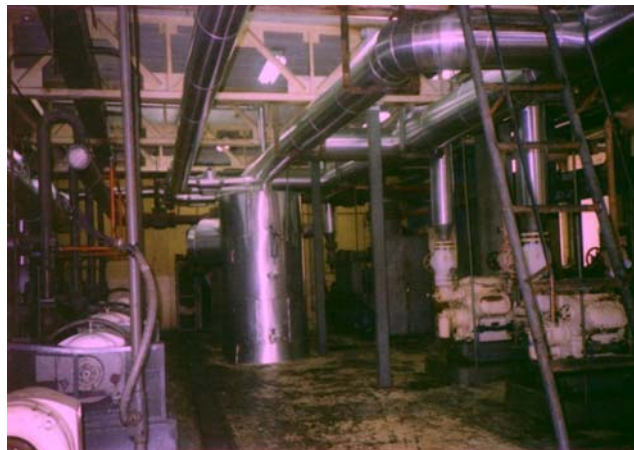
Figura 2.11 Aislamiento de Tuberías y Tanques
