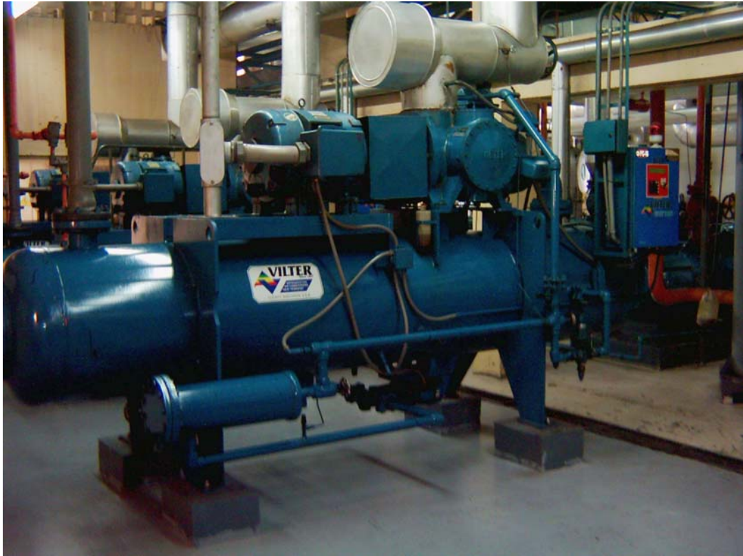
Figura 2.2 Compresor de Tornillo VSS 1051
