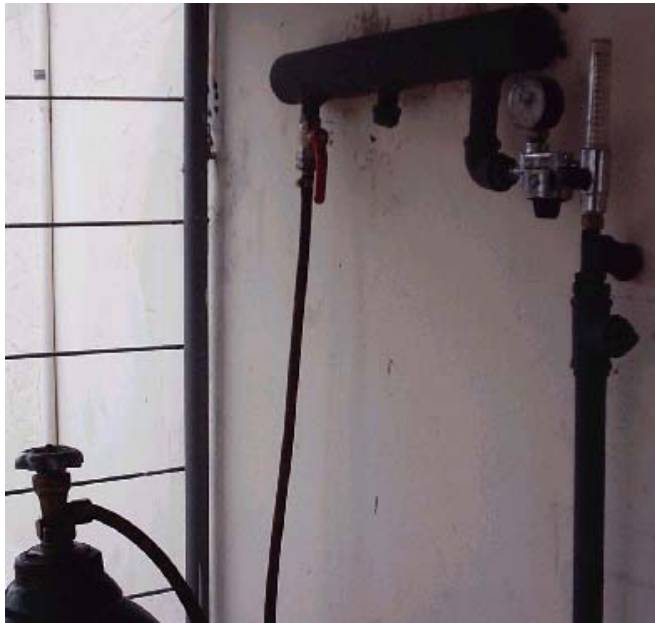
Foto 9: Válvula reguladora de O 2
