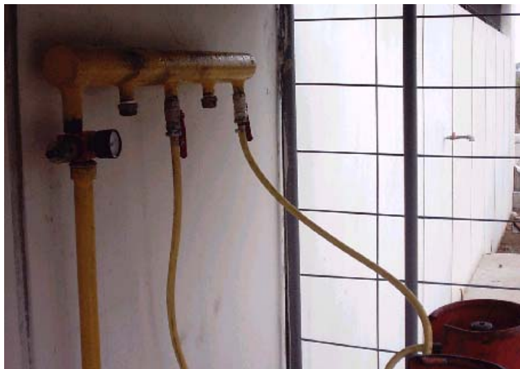
Foto 10: válvula reguladora de GLP
