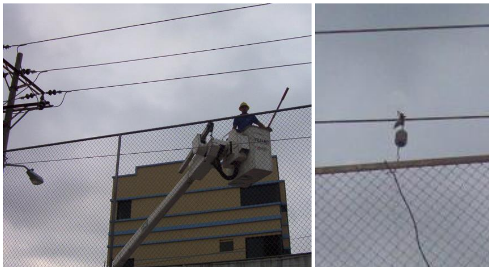
Figura 5-5 : Instalación del acople capacitivo sobre la red de media tensión (izquierda). Acople capacitivo ya instalado (derecha) [37].
