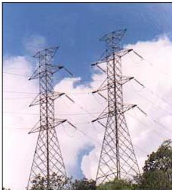
Figura 2-4 Torres de Distribución [15]
