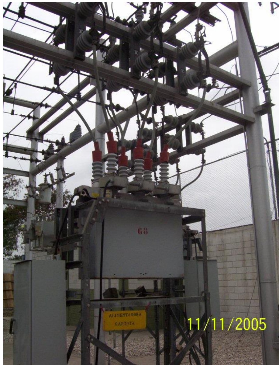
Figura 5-4 Alimentadora llamada Garzota de la subestación Garzota [37].
