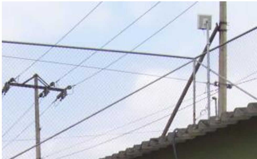
Figura 5-3 Antena instalada por la compañía ESPOLTEL dentro de la subestación eléctrica Garzota en la ciudad de Guayaquil [37].
