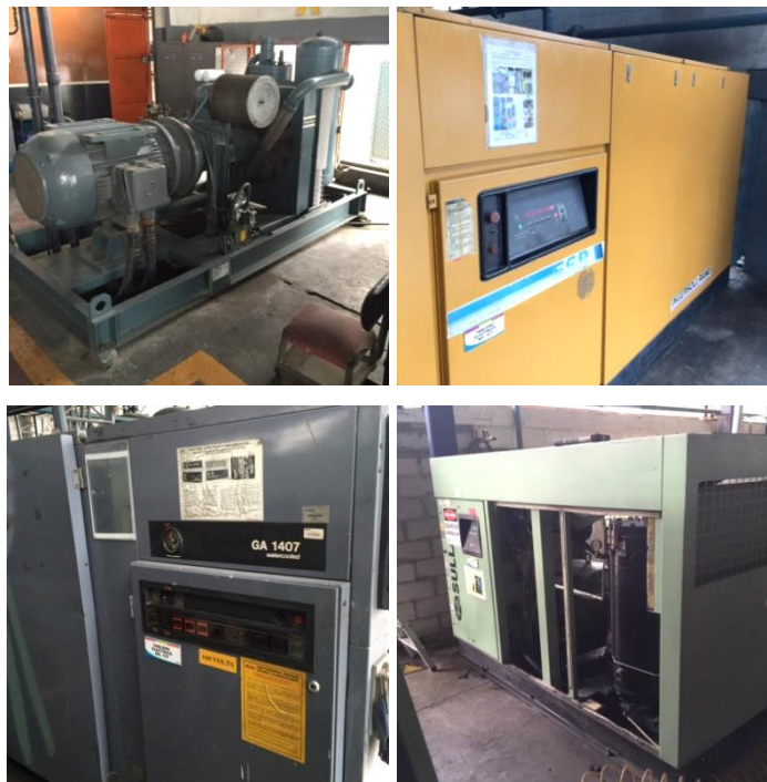
Fig. 1-1 Compresores de la planta de estudio
