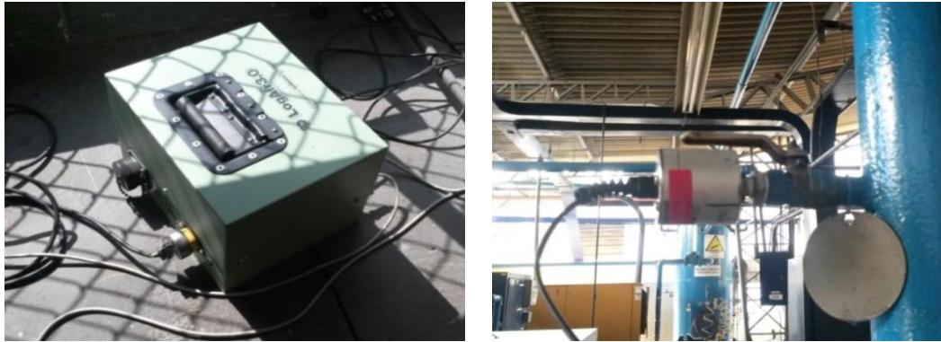
Fig. 2-1 Datalogger – Medidor de Flujo
