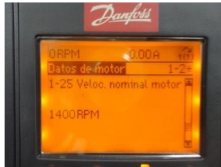
Figura 11.35: Configuración del parámetro 1-25 Velocidad nominal motor [A].
