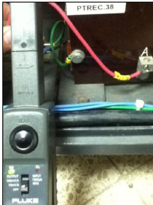
Figura 3.41 Conexión de la punta de prueba de corriente para adquirir la medición eficaz de la corriente del primario del transformador monofásico PTREC.38
