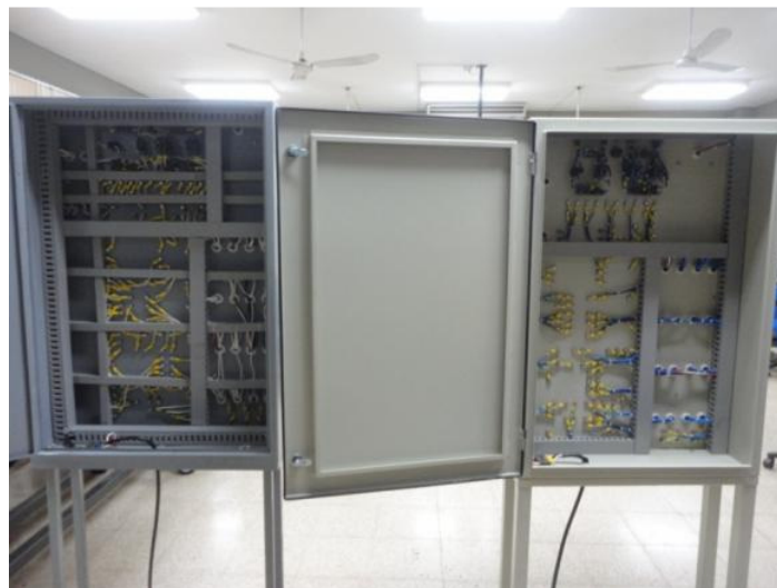
Figura 9.2: Vista posterior de los paneles eléctricos Altistart: original (izquierda) y réplica (derecha).
