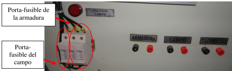
Figura 5.11: Porta-fusibles de campo y armadura, luz piloto de habilitación de voltaje de campo y borneras de conexión hacia el tacogenerador, campo y armadura del motor DC.
