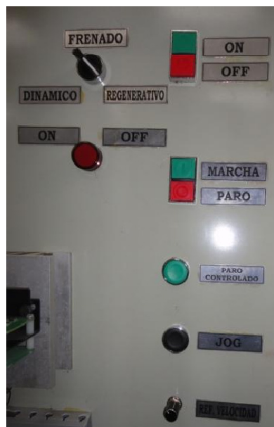
Figura 5.12: Selector de frenado SEL, las botoneras ON, OFF, MARCHA, PARO, PARO CONTROLADO, JOG y el potenciómetro de referencia de velocidad.
