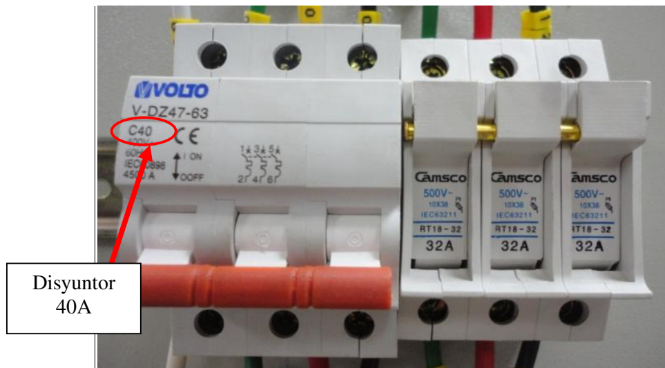
Figura 7.4: Disyuntor de 40A y tres porta-fusibles principales.
