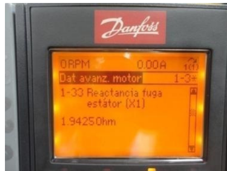
Figura 11.52: Parámetro 1-33 Reactancia fuga estator (X1).
