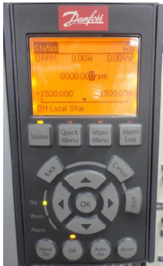
Figura 11.22: Interfaz del drive Danfoss encendida y relé auxiliar 1 energizado.
