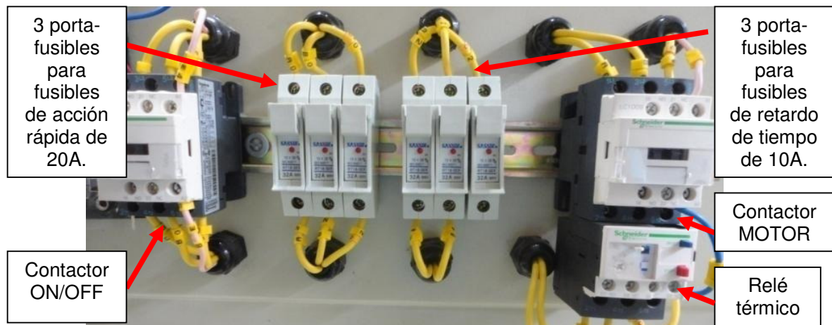
Figura 10.5: Contactor ON/OFF, porta-fusibles para fusibles de acción rápida de 20A, porta-fusibles para fusibles de retardo de tiempo de 10A, contactor MOTOR y relé térmico.
