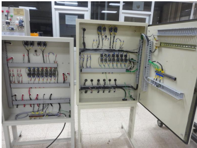
Figura 11.2: Vista posterior de los paneles eléctricos Danfoss: réplica (izquierda) y original (derecha).
