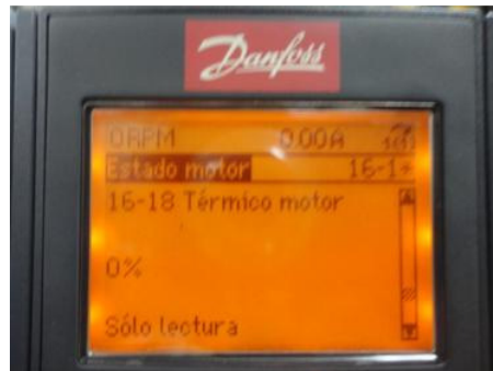
Figura 11.92: Parámetro 16-18 Térmico motor.
