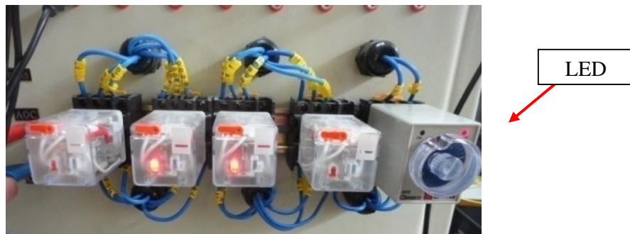
Figura 10.135: Estado de los relés luego de finalizada la temporización del relé TEMPORIZADOR.
