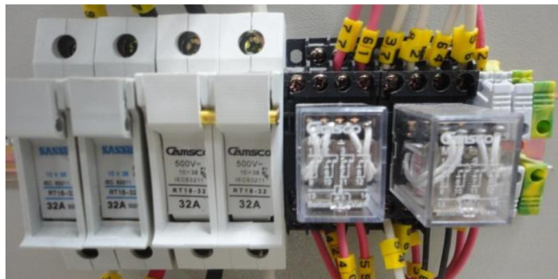
Figura 7.8: Porta-fusible para la armadura, para el circuito de campo y dos porta-fusibles para alimentar el panel de operador y dos relés auxiliares
