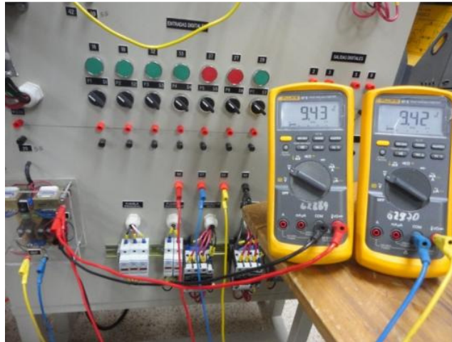
Figura 11.159: Voltaje de entrada y voltaje de salida de la tarjeta electrónica del panel eléctrico Danfoss.
