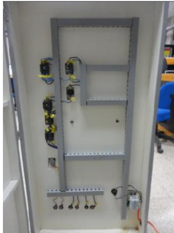
Figura 5.2: Parte posterior del panel eléctrico Fincor original.
