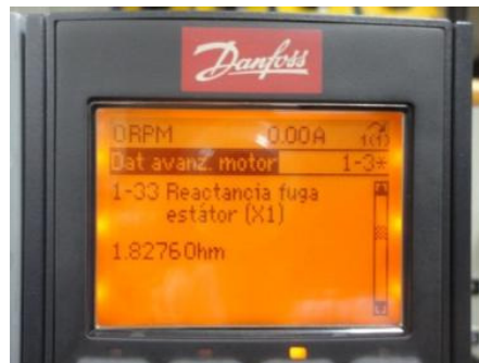
Figura 11.40: Parámetro 1-33 Reactancia fuga estator (X1).
