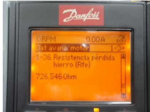
Figura 11.43: Parámetro 1-36 Reactancia pérdida hierro (Rfe).
