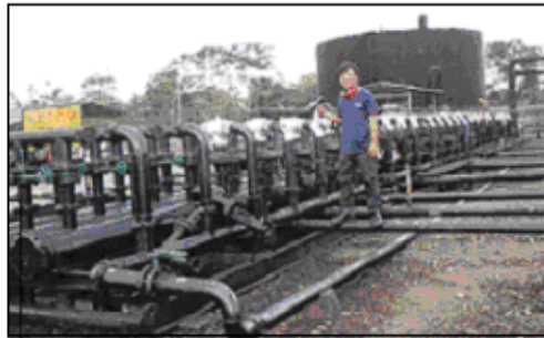
Figura 2: Manifold o Distribuidor de flujo
