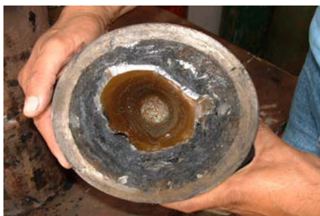
FIGURA 18: Fotografía de una tubería con obstrucción
