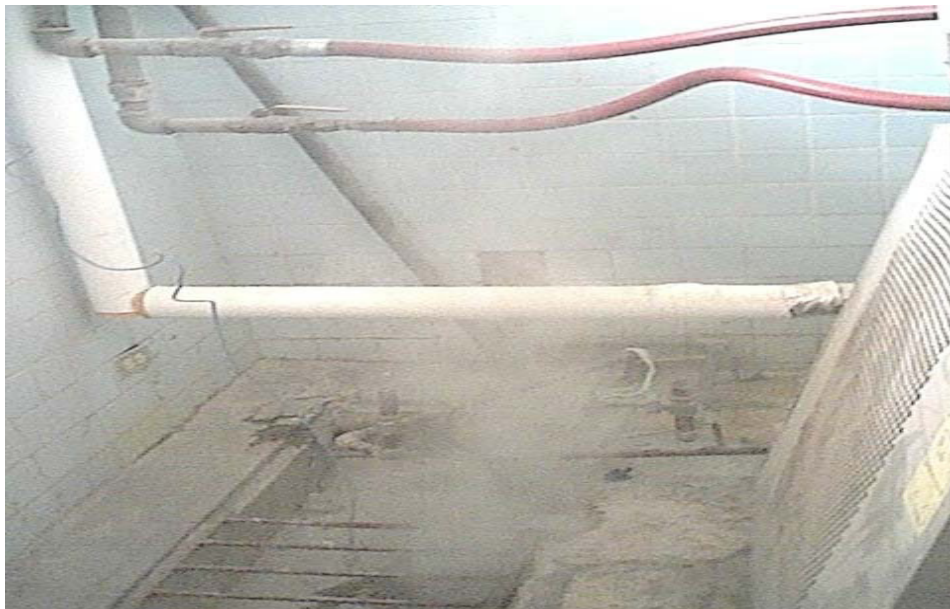
Figura 7.2 : Ausencia de trampas de vapor en lavandería.
