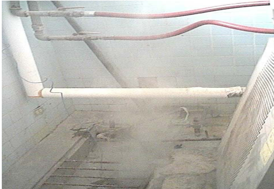
Figura 6.7 : Ausencia de retorno del condensado y trampas de vapor en las máquinas para lavar. El condensado y parte de vapor se desperdicia enviándolos por un desagüe.
