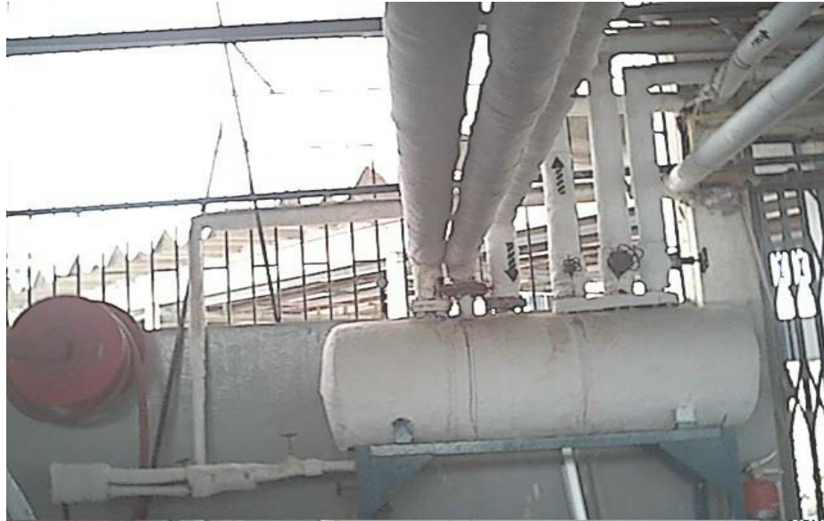
Figura 6.6 : Recubrimiento aislante que contiene asbesto.
