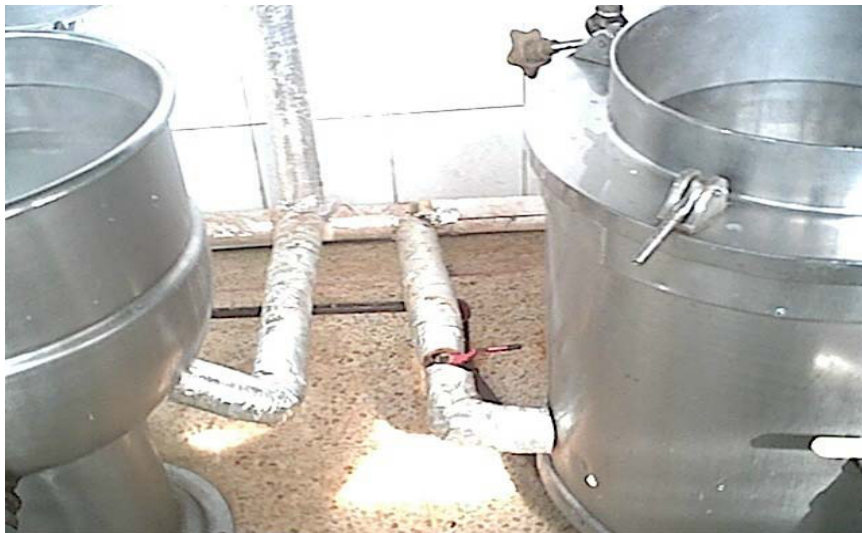
Figura 7.3 : Ausencia de trampas de vapor en marmitas.
