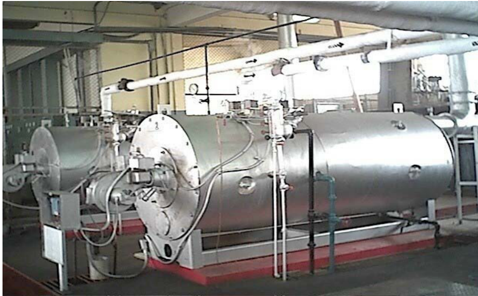
Figura 7.1 : Ausencia de trampas de vapor en tuberías principales que salen de las calderas.
