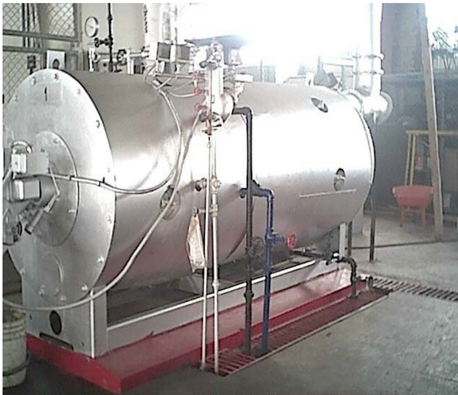
Figura 3.7 : Mediante las purgas de superficie ( tubería negra ),se está eliminando condensado hacia los desagües, desperdiándose energía , que puede ser recuperada.
