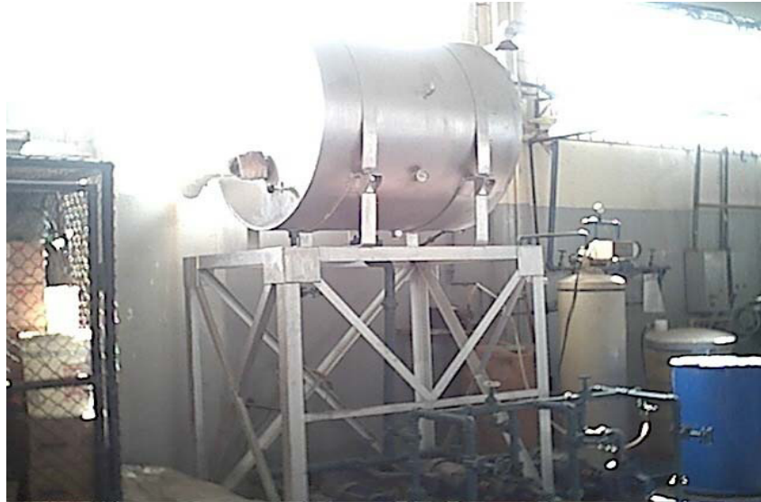
Figura 3.1 : Tanque existente para agua de alimentación .
