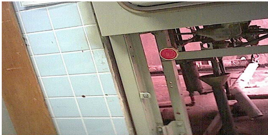
Figura 6.8 : En los equipos esterilizadores del quirófano, el condensado se desecha por un simple “embudo” que conecta a un desagüe.
