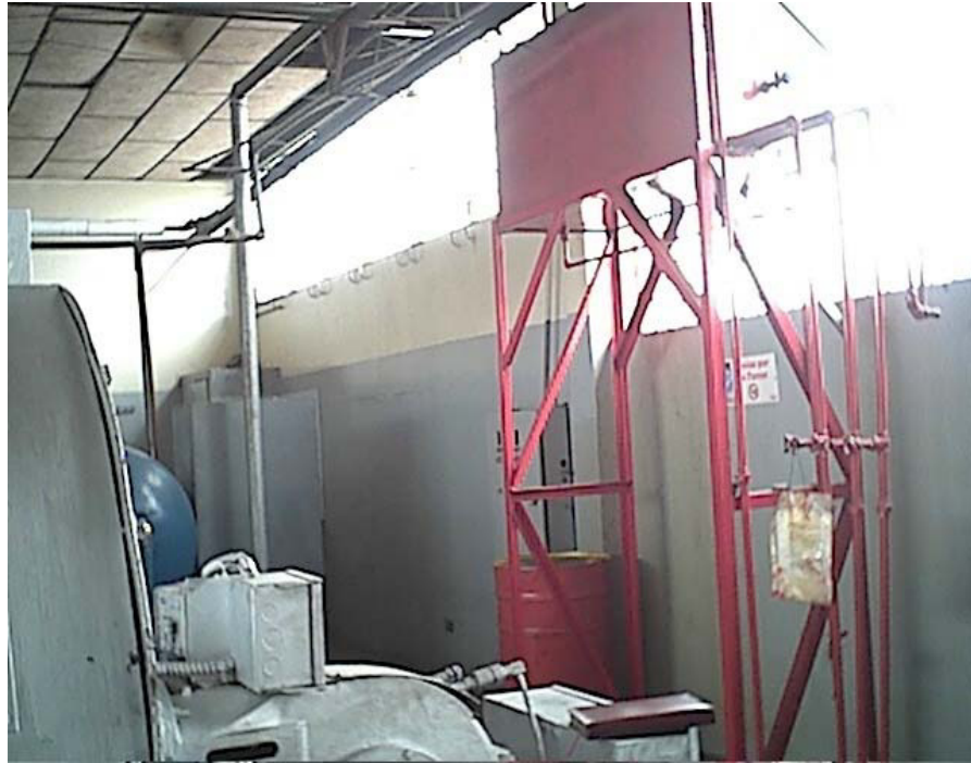
Figura 4.2 : Tanque diario de combustible.
