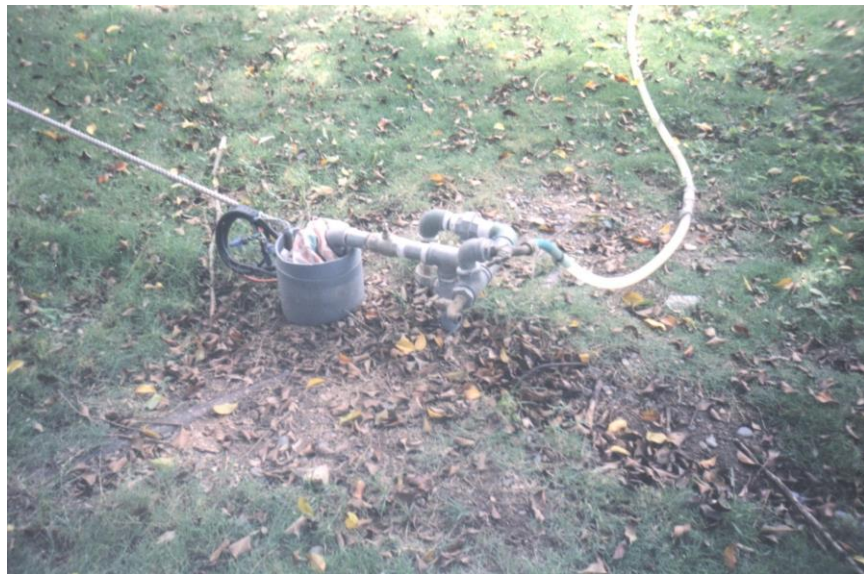
Figura 1.6 Pozo de agua subterránea
