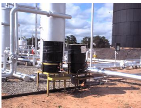
Figura 3.6: Bombas de Inyección de Químicos.
