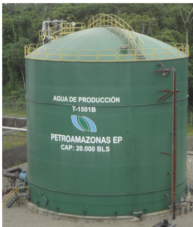
Figura 3.8: Tanque de Almacenamiento de Agua de Producción. Fuente: Registro Fotográfico Campo Palo Azul Bloque 18.
