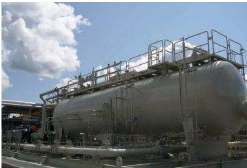
Figura 3.4: Separador instalado en CPF. Fuente: Registro Fotográfico Campo Palo Azúl Bloque 18.
