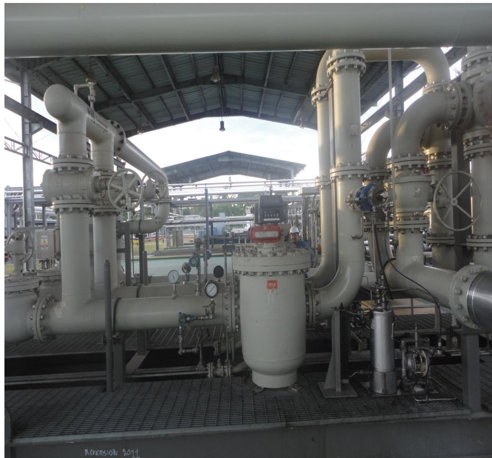
Figura 3.9: Unidad LACT. Fuente: Registro Fotográfico Campo Palo Azul Bloque 18.
