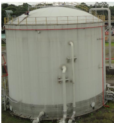
Figura 3.7: Tanque de Almacenamiento de Crudo. Fuente: Registro fotográfico del Campo Palo Azul Bloque 18.
