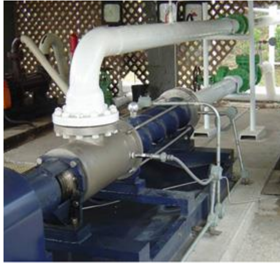
Figura 2.11 Bombas de Descarga
