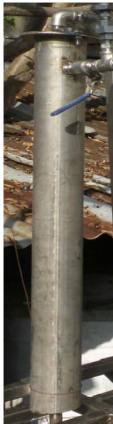
Figura 3.10 Enfriador de condensado
