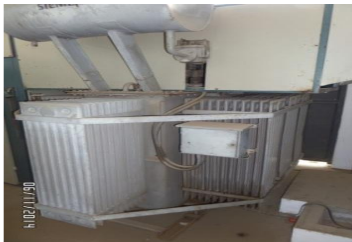
Figura 1.5: Transformador de 1250 KVA
