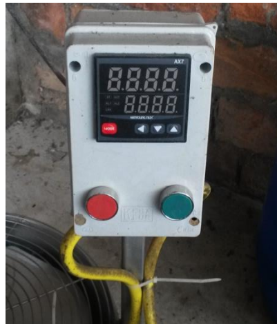
Figura 1.7: Panel del PLC y Electroválvulas.
