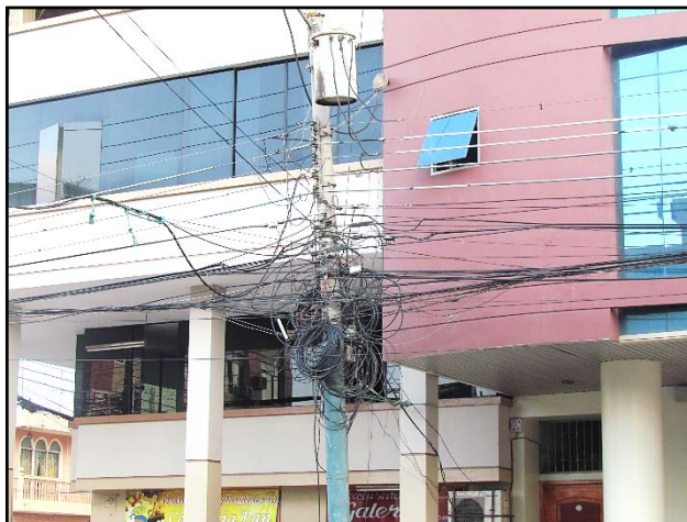
Figura 1.6: Reservas desordenadas en ubicaciones incorrectas, calle Buenavista entre la Av. 25 de Junio y Sucre
