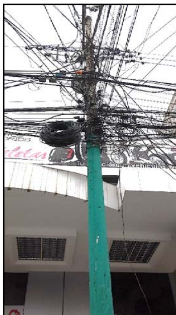
Figura 1.7: Reserva en exceso en la calle Buenavista y Olmedo.
