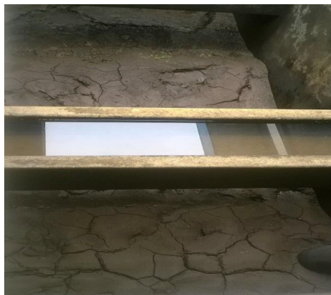
Figura 2.4 Cámaras de filtración
