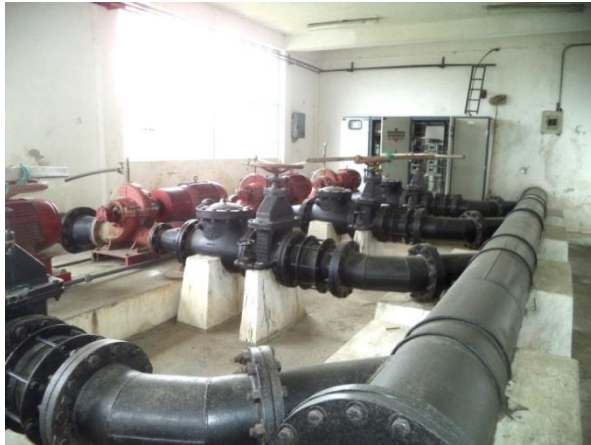
Figura. 1.10 Sala de bombas
