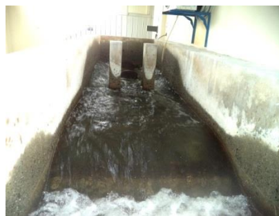
Figura 1.6 Cámara de Llegada Aguas Superficiales
