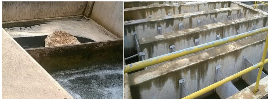
Figura 1.8 Unidad de Floculación.
