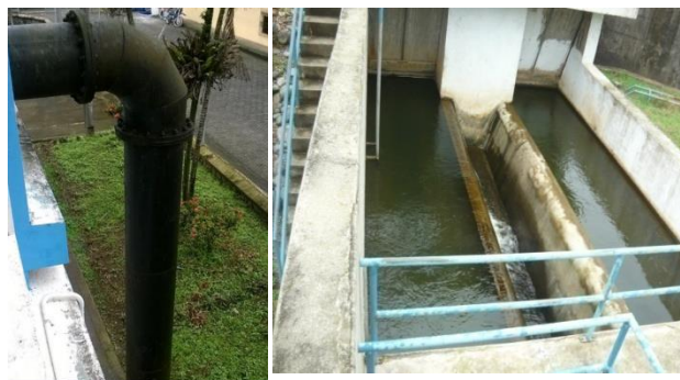
Figura1.2 Tubería HD y Canal de captación
