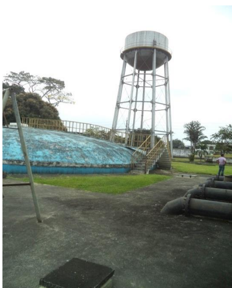
Figura 1.11 Tanques de Reserva
