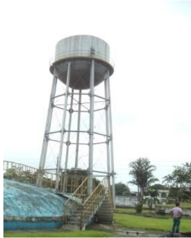
Figura 2.5 Tanque elevado para Zona alta de Quevedo
