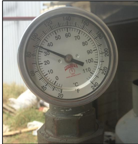
Figura 2.6 Termómetro ubicado a la entrada del intercambiador de calor.
