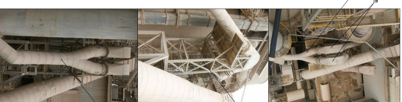
Ducto "Y" de Conexion
