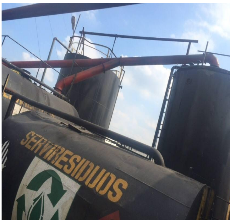
Figura 3.4: Foto que muestra la disposición de la tubería de descarga de vapor del destilador
