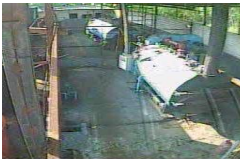
Figura 3.3: Foto que muestra el Caldero que se instalo
