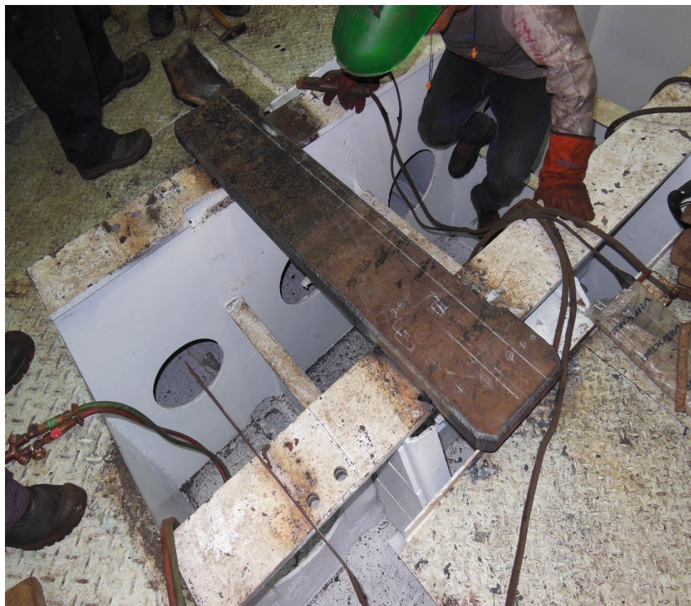
FIGURA 2.4: ADECUACION DE LAS BASES DEL MOTOR
