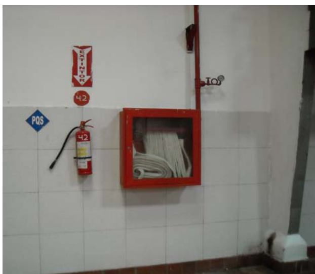
Figura 15. Extintor y Señalética
