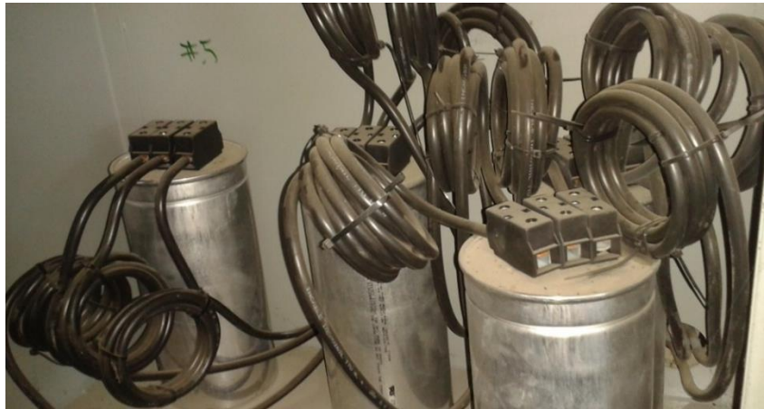
Figura 3.12: Grupo de condensadores de 50 kVAr.
