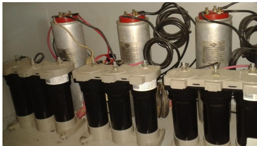
Figura 3.13: Grupo de condensadores de 30 kVAr.
