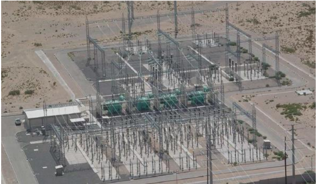
Figura 1.2: Subestación eléctrica a intemperie.
