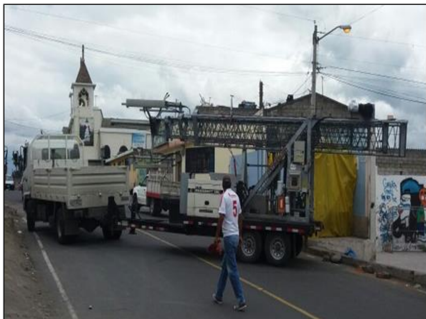
Figura 1.14: COW reubicada e instalada en Jama-Manabí
