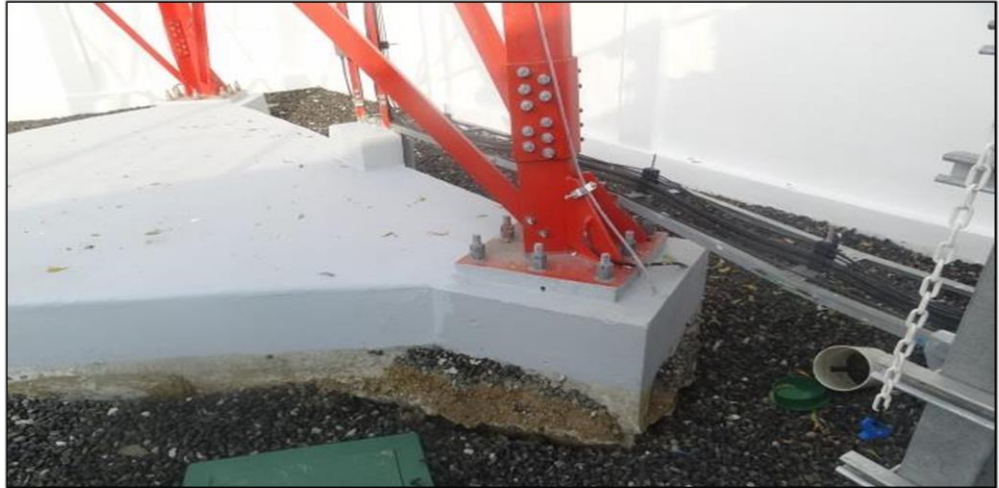
Figura 1.10: Desnivel y cuarteamientos en la base de la torre auto-soportada de telecomunicaciones, CNT-Cojimies
