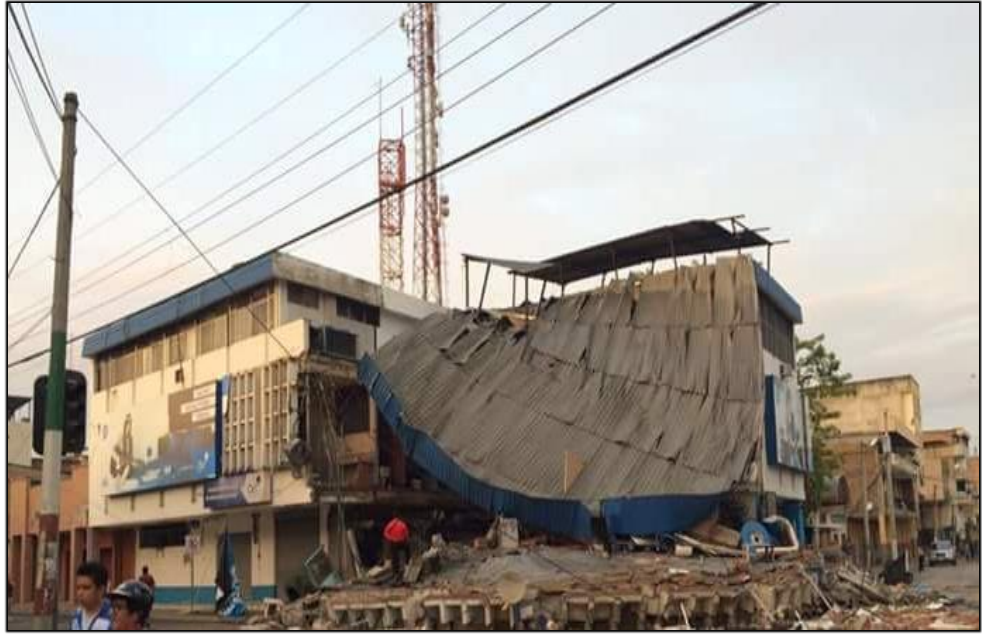
Figura 1.4: Central Telefónica destruida, CNT-Portoviejo
