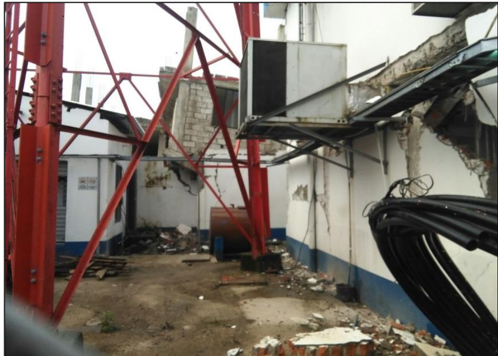
Figura 1.5: Daños en la Central Telefónica, CNT-Pedernales
