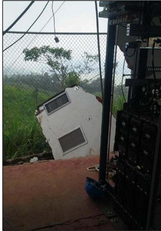
Figura 1.6: Estación repetidora destruida, CNT-Cerro Nueve-Jama
