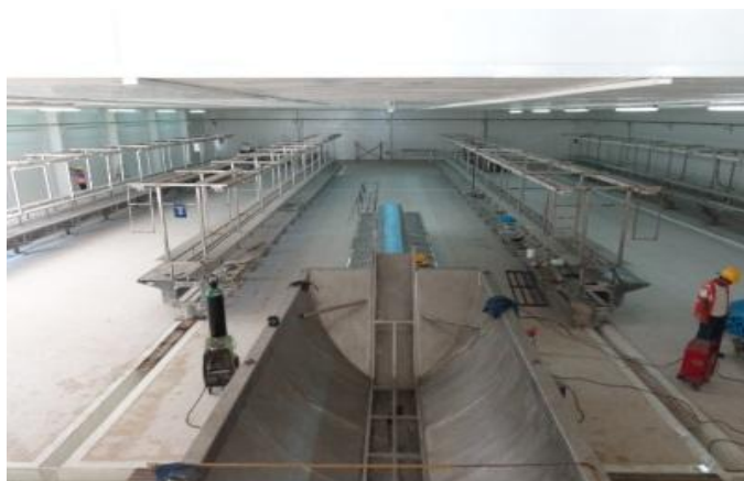
Figura 1.3: Habilitación eléctrica de planta pelágico.
