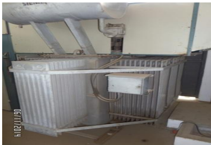
Figura 1.5: Transformador de 1250 KVA
