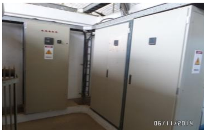
Figura 1.6: Tablero de capacitores y tablero de distribución principal
