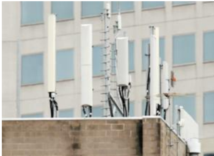
Figura 0.3. Antena Celular sobre un piso alto.
