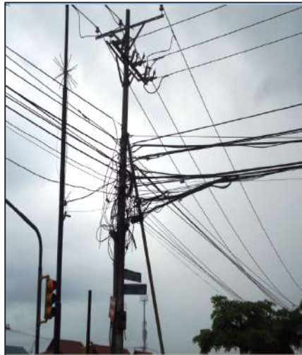
Figura 1.14 Poste ubicado en ciudadela Mapasingue Oeste, Vía a Daule y calle primera.
