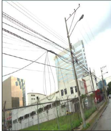
Figura 1.16 Poste ubicado en la ciudadela Nueva Kennedy, Av. Luis Orrantia y calle Manuel Eduardo Castillo
