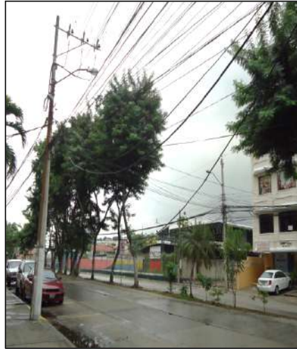
Figura 1.34 Poste ubicado en la ciudadela Nueva Kennedy, Av. Luis Orrantia y calle Manuel Eduardo Castillo
