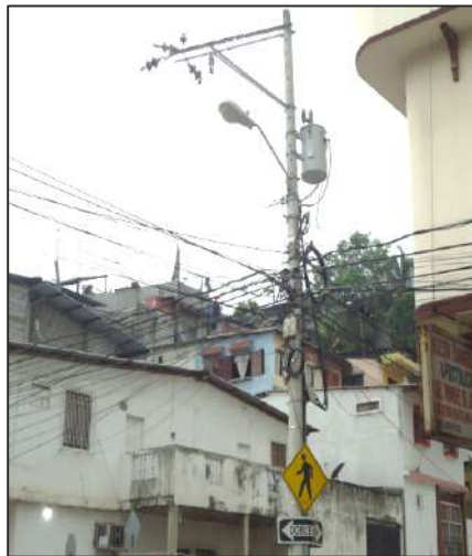
Figura 1.17 Poste ubicado en ciudadela Mapasingue Este, calle Novena y calle segunda
