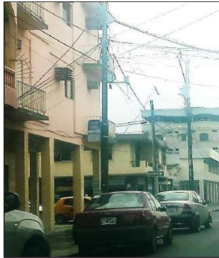
Figura 1.25 Equipo instalado en poste, Calles Guaranda y Cuenca.
