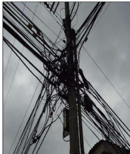
Figura 1.13 Poste ubicado en la ciudadela Nueva Kennedy, Av. Luis Orrantia y calle Justino Cornejo
