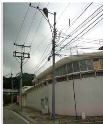
Figura 1.1 Poste ubicado en la ciudadela Los Ceibos calles Elio Estévez Bejarano y Av. Primera.
