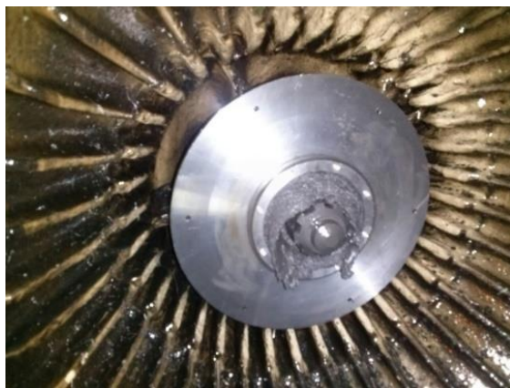
Figura 1.11 Alta contaminación por hollín en alabes de turbina
