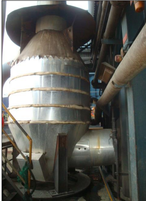
Figura 1.4 Recuperador de energía, producción de vapor 6580kg/h.
