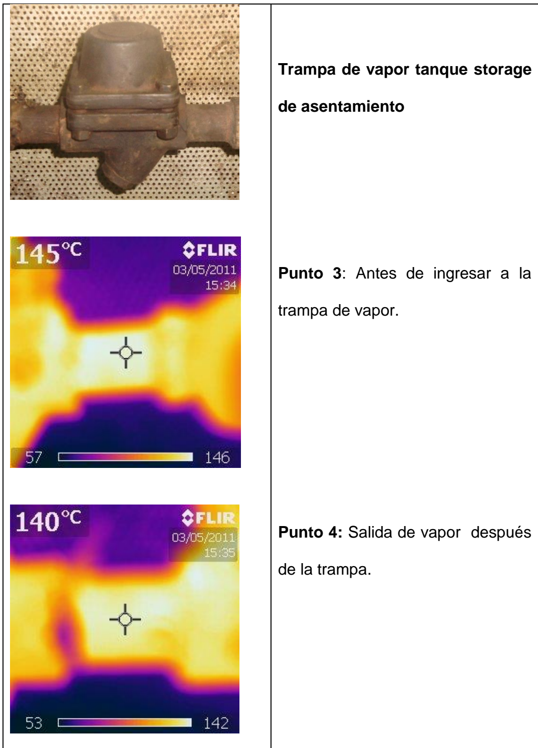
Figura 2.3 Imágenes térmicas en tanque storage.
