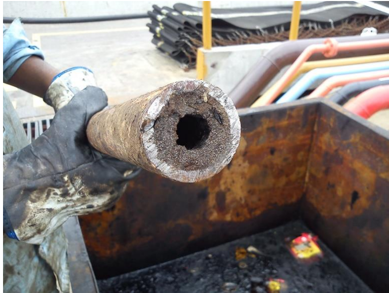
Figura 2.16 Contaminación por bunker en línea de vapor.
