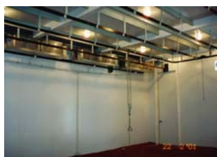
Figura 5.11 Cámara de Frío Fuente: Promotor del Proyecto
