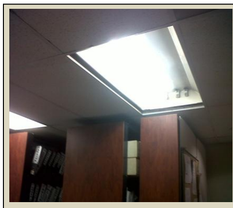
Figura 4.3 Luminarias sin protección
