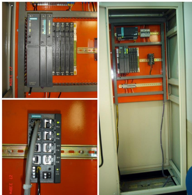
Figura 7: Tablero Unidad Central S7-400
