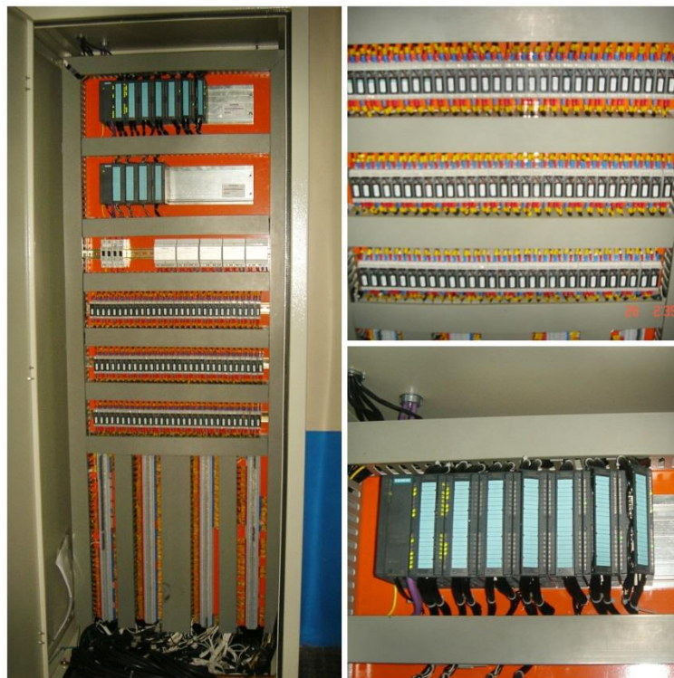
Figura 11: Estación remota ET-200M - 4 (Arrancadores).
