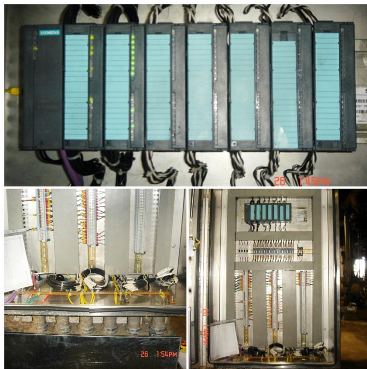
Figura 8: Estación remota ET-200M – 1 (INSTRUMENTACIÓN – P BAJA).
