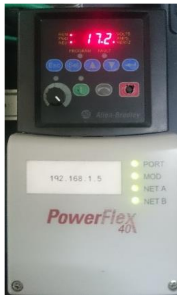
Figura 51: Modo “Decelerating” del variador Power Flex 40
