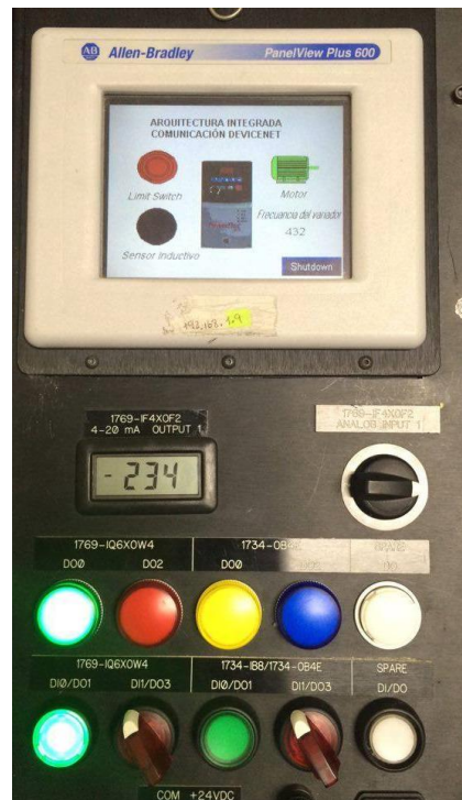
Figura 16: Indicadores del estado de Reversa del variador
