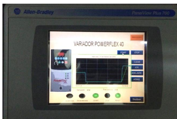
Figura 13: Cambio de frecuencia en el variador
