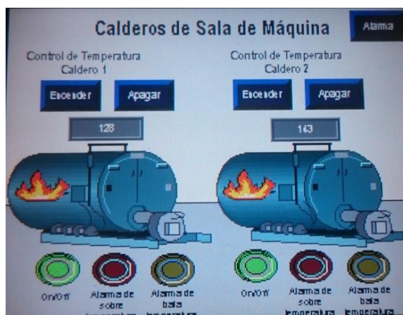
Figura 23: Ambos calderos energizados
