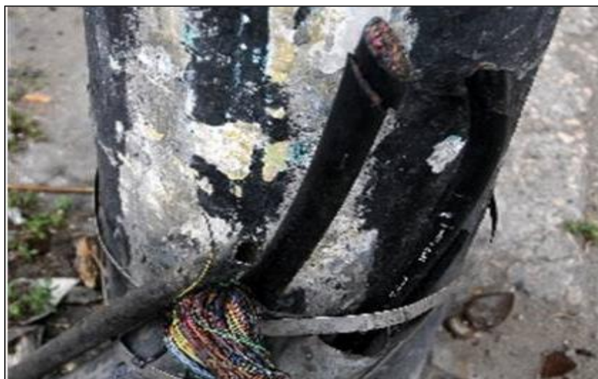
Figura 1.22 Cables cortados expuestos a pocos metros del suelo
