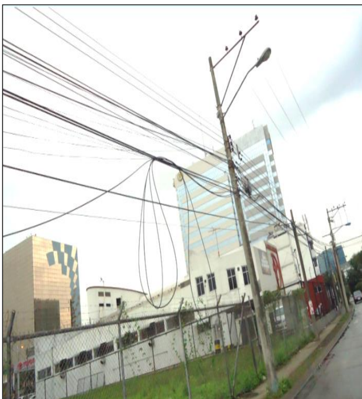
Figura 1.16 Poste ubicado en la ciudadela Nueva Kennedy, Av. Luis Orrantía y calle Manuel Eduardo Castillo
