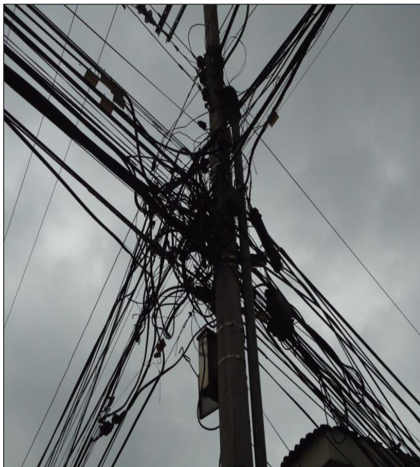
Figura 1.13 Poste ubicado en la Ciudadela Nueva Kennedy, Av. Luis Orrantía y calle Justino Cornejo
