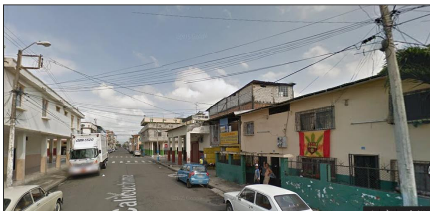
Figura 1.36 Tendido de cables a lo largo de la Calle Calicutima Google Maps
