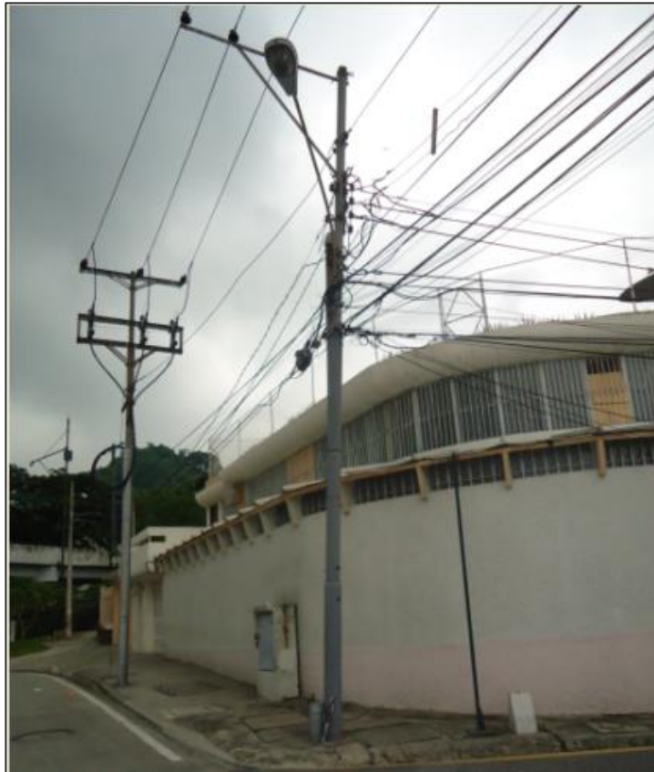
Figura 1.1 Poste ubicado en la ciudadela Los Ceibos calles Elio Estévez Bejarano y Avenida Primera.
