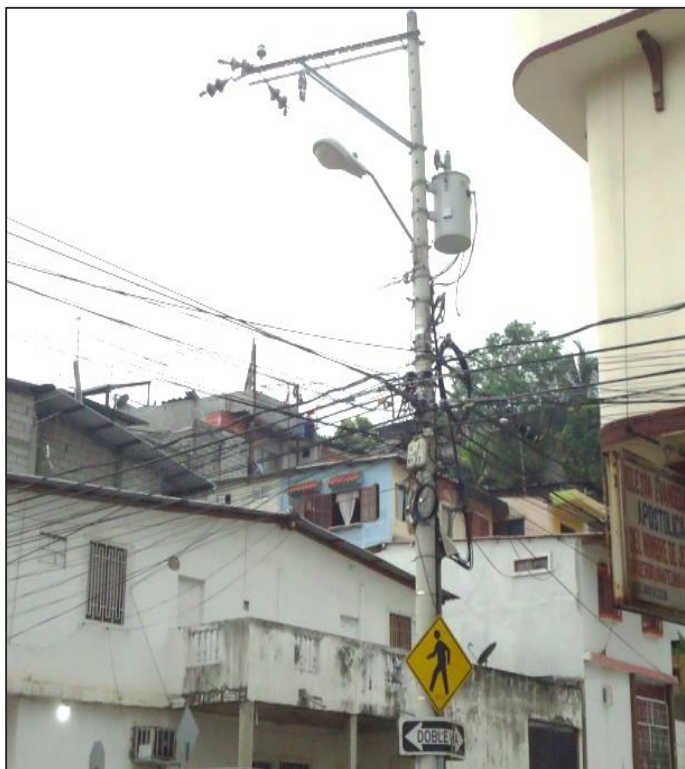
Figura 1.17 Poste ubicado en ciudadela Mapasingue Este, calle Novena y calle segunda
