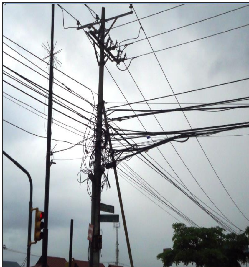
Figura 1.14 Poste ubicado en ciudadela Mapasingue Oeste, vía a Daule y calle primera.
