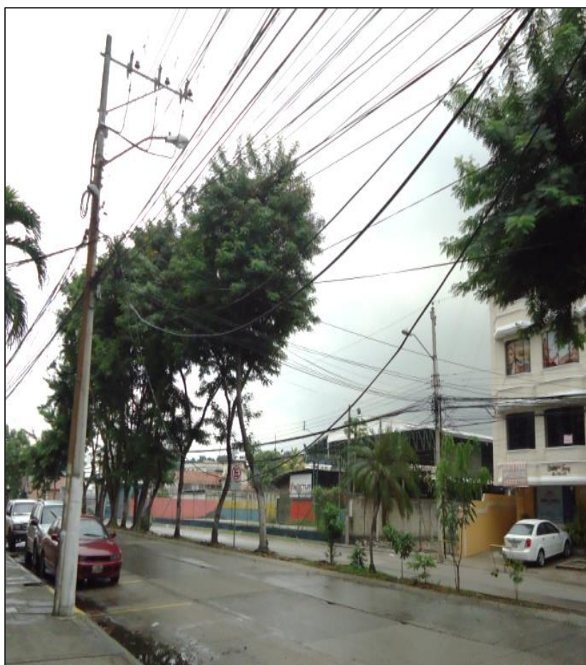
Figura 1.34 Poste ubicado en la ciudadela Nueva Kennedy, Av. Luis Orrantía y calle Manuel Eduardo Castillo
