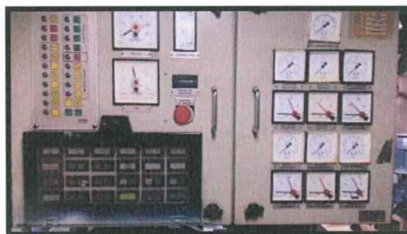
Figura 2. Estación Sala de Máquinas
