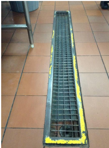
Gráfico 5. 5: Rejillas de piso
