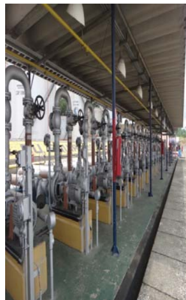
4.- Encender bombas de despacho.
